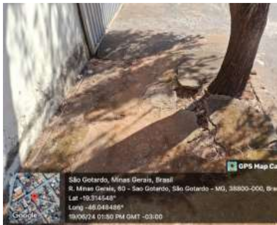
Figura 03: Vista da calçada danificada por um dos indivíduos arbóreos.
