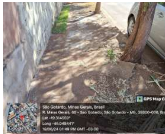
Figura 04: Vista da calçada danificada por um dos indivíduos arbóreos.
